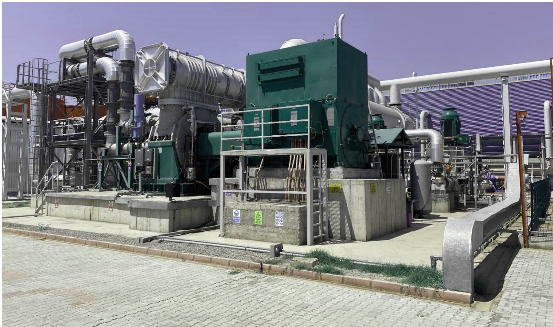
KIPER ELEKTRIK/KIPER 1,TURKEY/12 MWe
